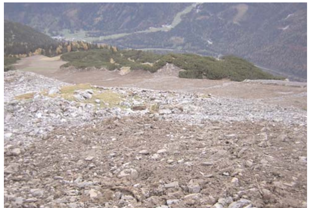
Abbildung 2: Pistenbau mit sehr starken Geländeeinschnitten
